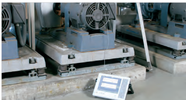
データバレットと加速度検出器NPシリーズによるプラント設備の振動計測
